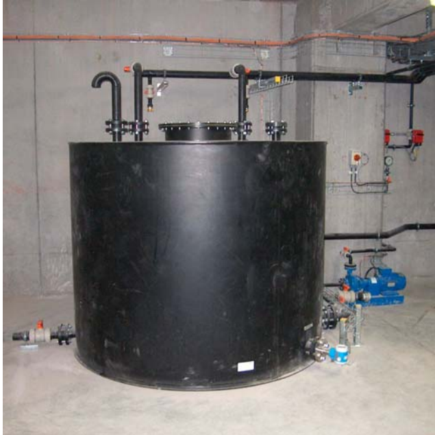
Pufferbehälter (4m 3 ) aus PE-Plattenmaterial
